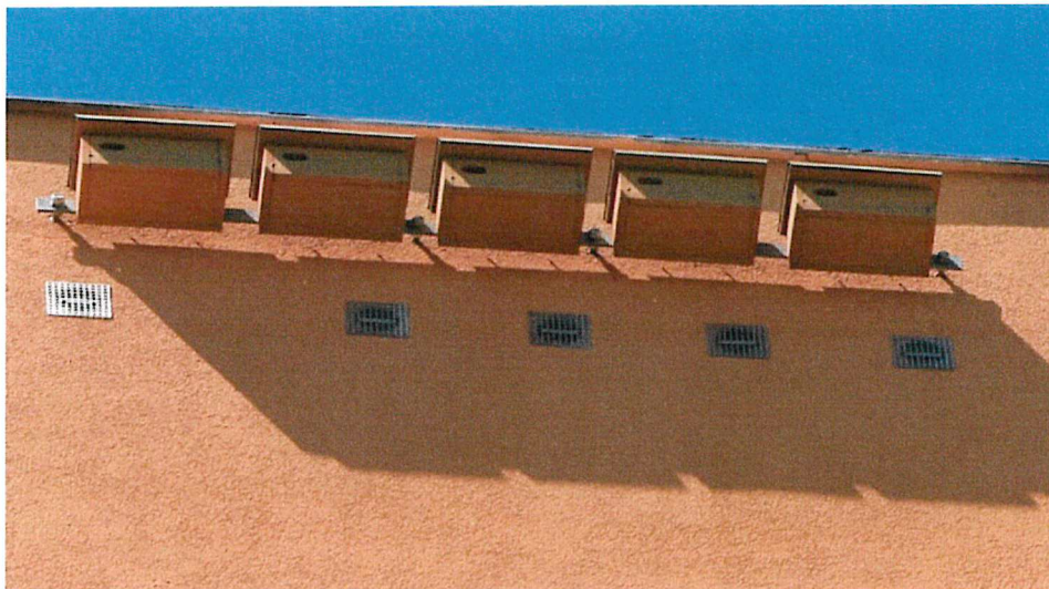
Ryc. 6. Przykładowy sposób zamocowania pięciu budek dla jerzyka typu APK-1 do budynku – za pomocą plaskownika i czterech kotew mocujących plaskownik do ściany budynku, przechodzących przez warstwę termoizolacyjną.
